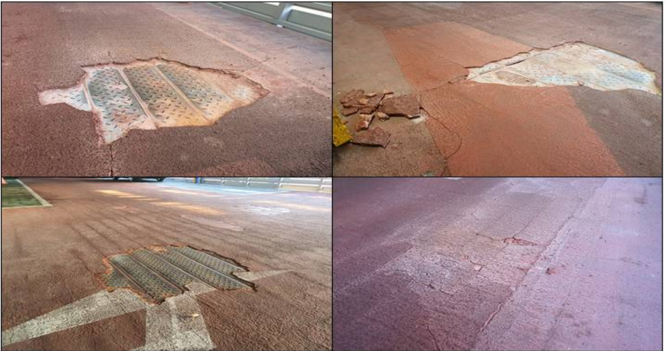
북변자주식주차장 바닥 아스콘 파손부위
